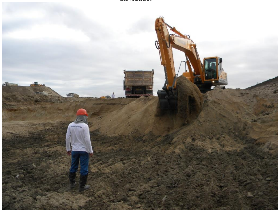
Figura 9: Acompanhamento de obra 13 - riscos físicos (ruídos, altas temperaturas, vibrações) presentes na atividade.
