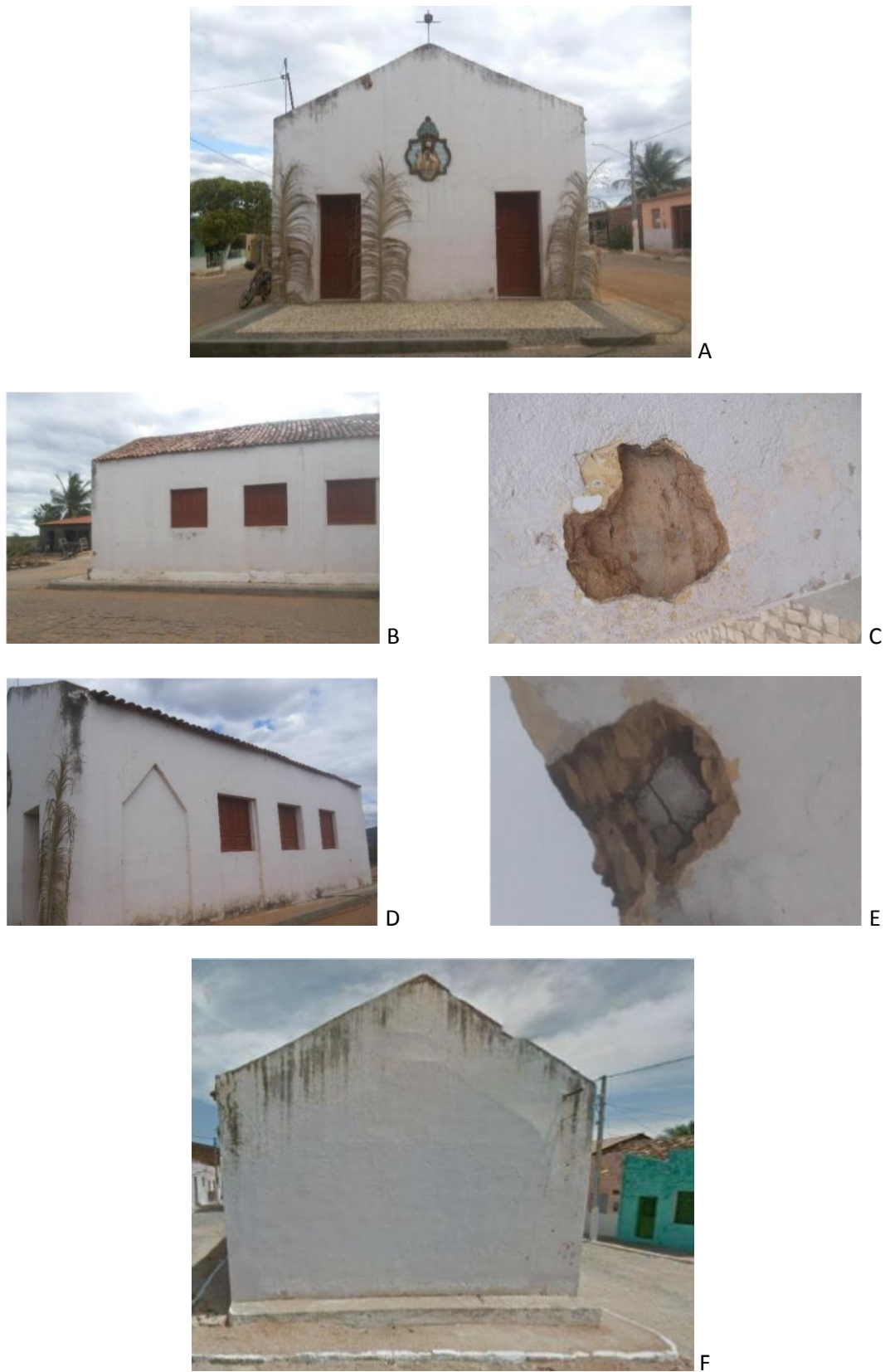
Figura 2: Exemplo da edificação de Carnaubeira da Penha, PE: a – fachada frontal; b – fachada lateral direita; c – detalhe construtivo; d – fachada lateral esquerda; e – detalhe construtivo da cobertura; f – fachada posterior.
