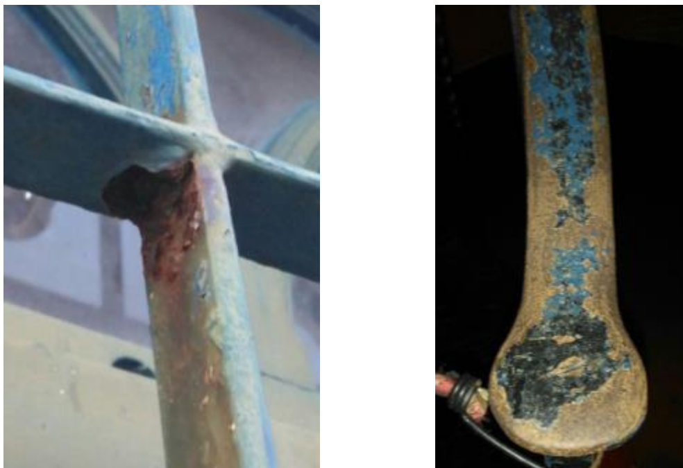
Figura 21 – A. Corrosão Alveolar na Janela Externa; B. Corrosão uniforme (ou generalizada) na Escada.
