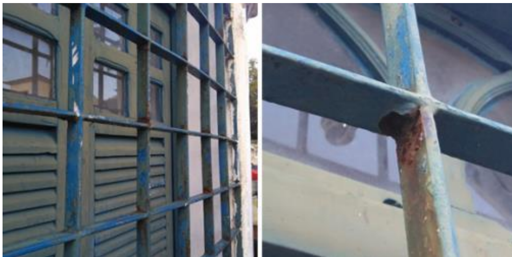
Figura 14 – Estado do material na grade da janela.
