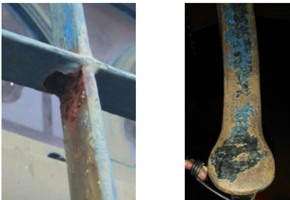
Figura 21 – A. Corrosão Alveolar na Janela Externa; B. Corrosão uniforme (ou generalizada) na Escada.
