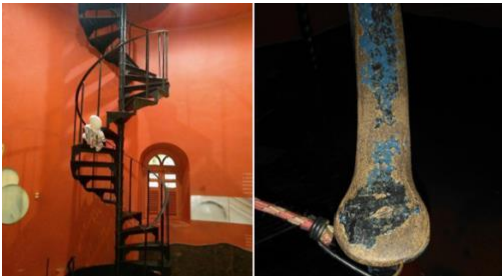
Figura 13 – Estado do material na escada.
