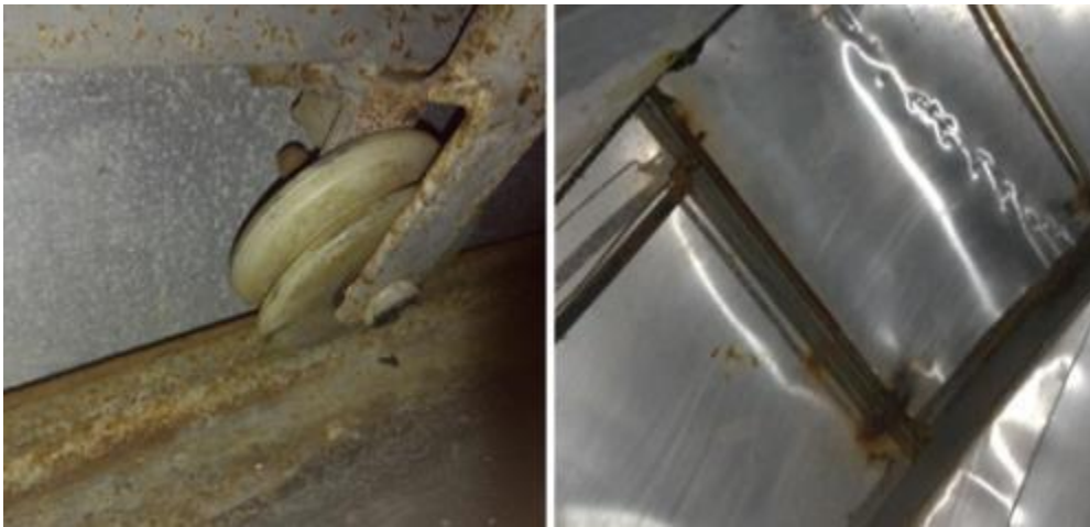
Figura 12 – Estado do material na cúpula.
