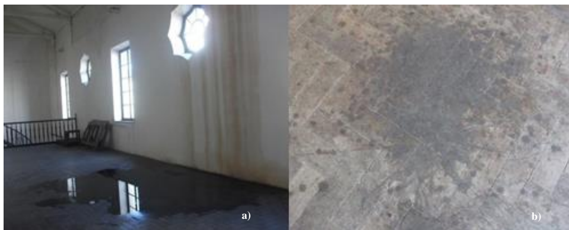
Figuras 10 (a e b): Acúmulo de água formado devido à inexistência de vidros nas janelas na ala superior; Presença de líquens no piso. Fonte: Acervo pessoal, 2013.
