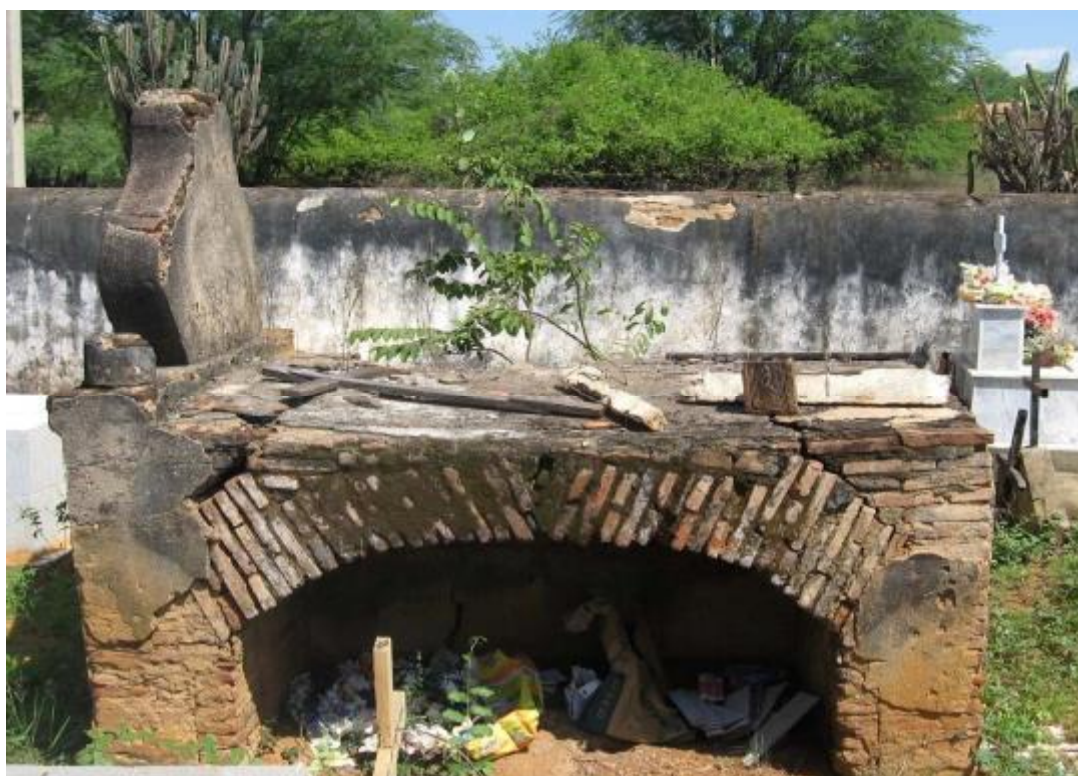
Figura 13: Mausoléu parcialmente destruído utilizado para depositar materiais e/ou lixo.
